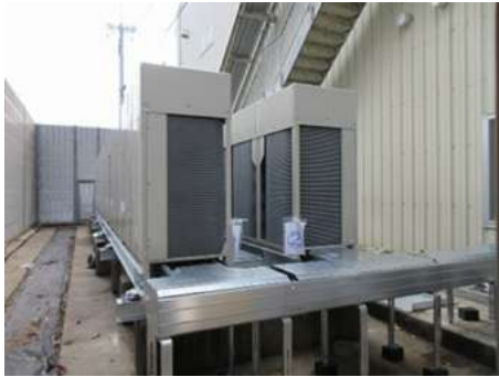
新設したパッケージエアコン（佐賀事業所）
