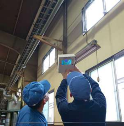
高所配管部のエア漏れ検出状況
